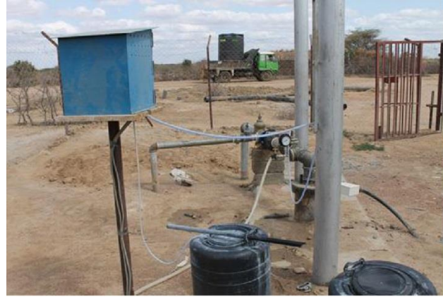
Abb. 2: Automatische Chlor-Einspeisungsanlage in einem der Dadaab-Camps (aus: UNHCR / SMU 2011)
